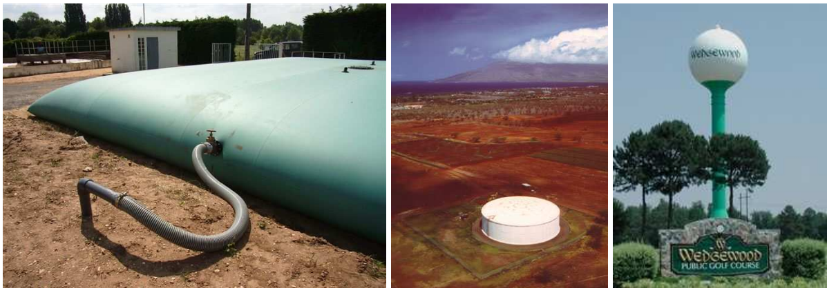
Figure 26 : Réservoirs opérationnels fermés
