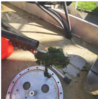
Figure 13 : Nettoyage d'un réacteur UV, encrassé par des algues
