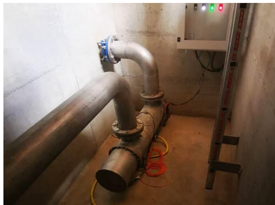
Figure 15 : Réacteur UV installé dans un regard, sous le niveau du sol
