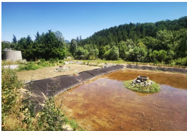
Figure 16 : Filtre à sable lent, installé en 2001 avec problème de colmatage et fuites vers le milieu récepteur
