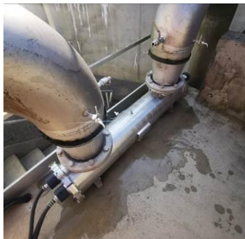
Figure 11 : Réacteur UV, installé au sol
