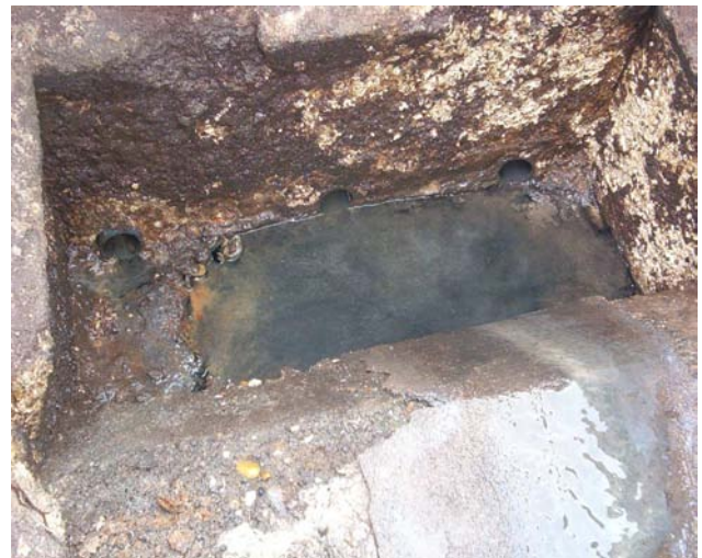
Dégradation du génie civil en béton en l'absence de couche protectrice
