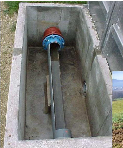
Déversoir d'orage avec un accès pour calibrage ou nettoyage
