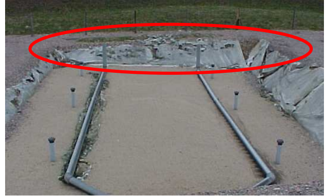
Dégradation des géotextiles
