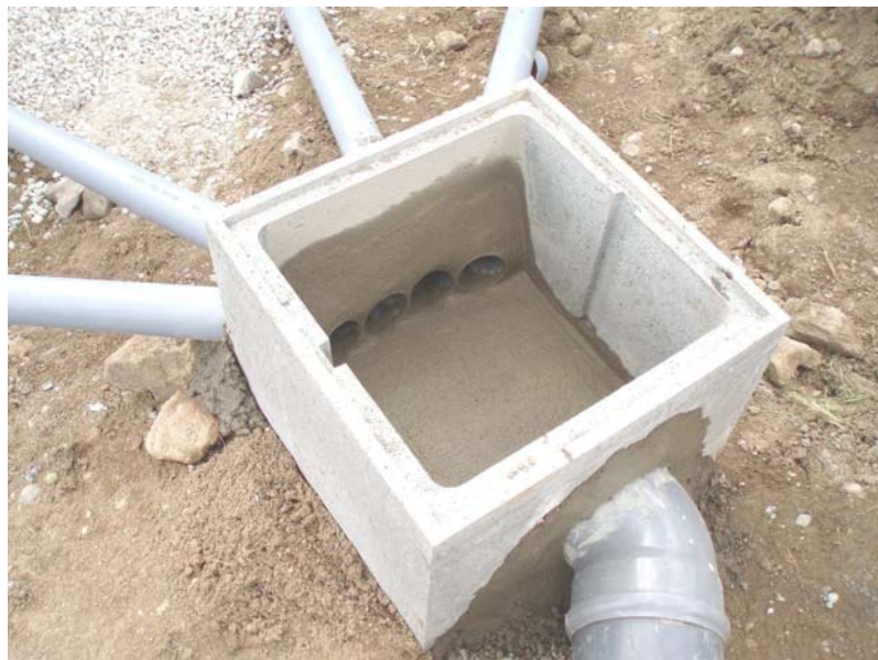
Regard de répartition : absence de garde d'eau
