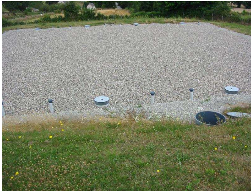
Figure 4 – Filtres à Sable Enterrés de Crespin (Aveyron) (photo: SATESE 12)
