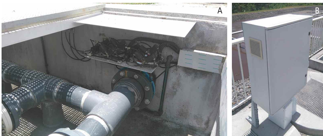
Figure 30. A) Protection des électrovannes contre le rayonnement solaire. B) Aération sur une armoire électrique.
