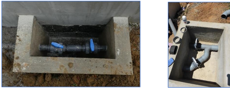
Figure 6 : Regard à vannes avec vannes à opercule (a) et vannes Guillotines (b) (©ETIage Guyane)
