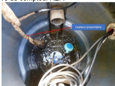
Sonde piézométrique 0-150 mBar dans poste de relevage
