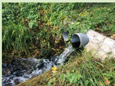
Rejet de sortie de station de traitement des eaux usées en milieu superficiel (fossé) – Crédit photo INRAE
